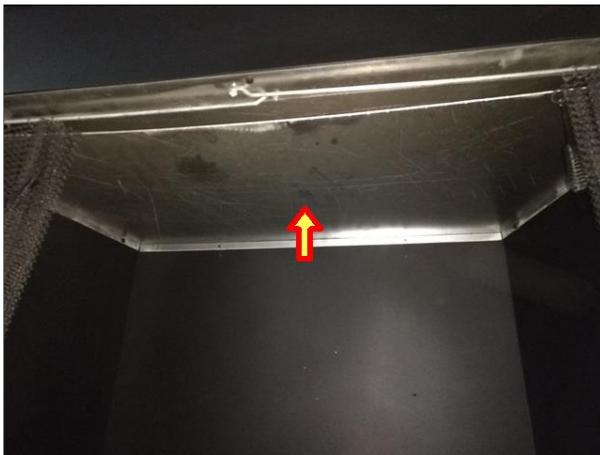
No chimney vent
